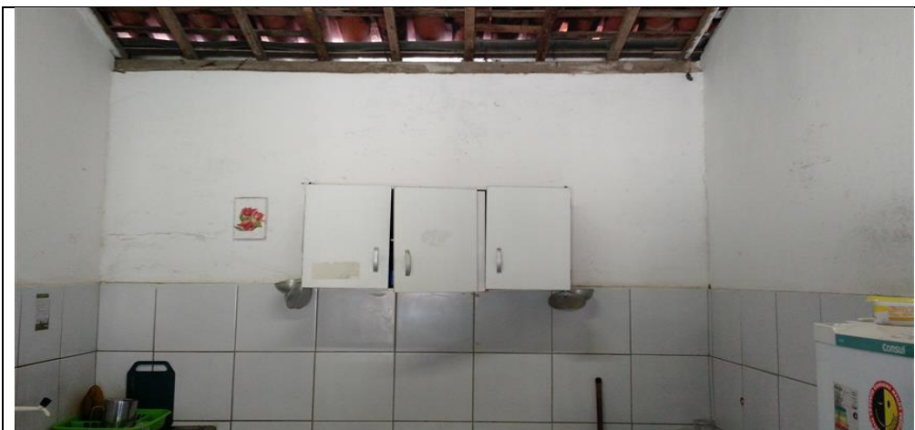
Foto - Teto com aberturas permitindo a entrada de insetos e outros contaminantes, , Ilha de Itamaracá (PE), 01 de julho de 2016
