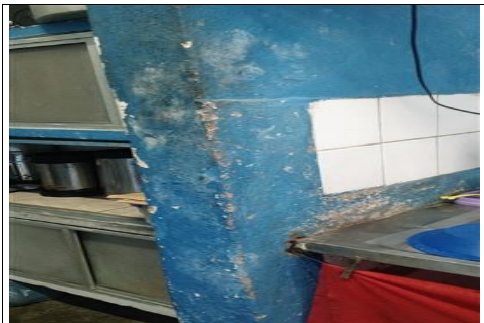
Foto - Frestas em paredes da cozinha, Ilha de Itamaracá (PE), 01 de julho de 2016
