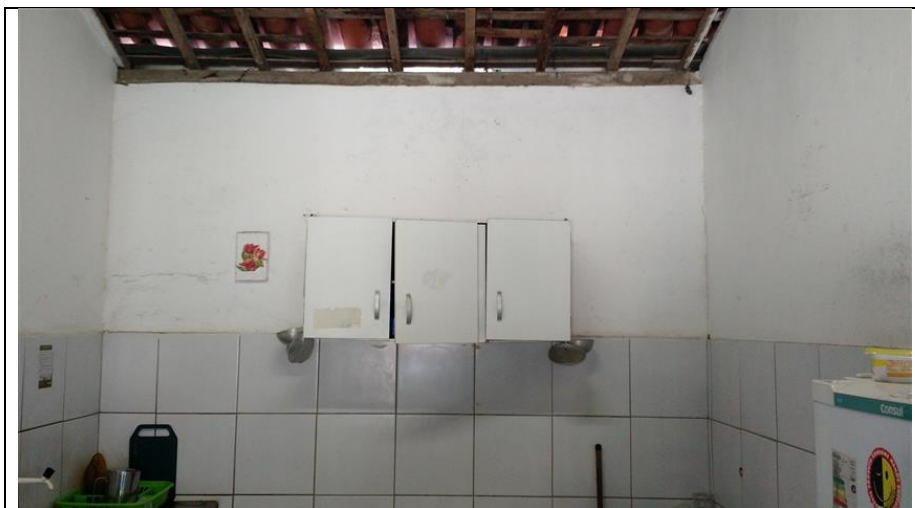
Foto - Cozinha sem janelas e sem exaustor, Ilha de Itamaracá (PE), 01 de julho de 2016
