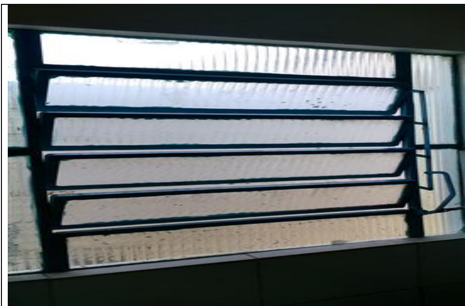
Foto - Janela sem tela de proteção milimétrica, , Ilha de Itamaracá (PE), 30 de junho de 2016
