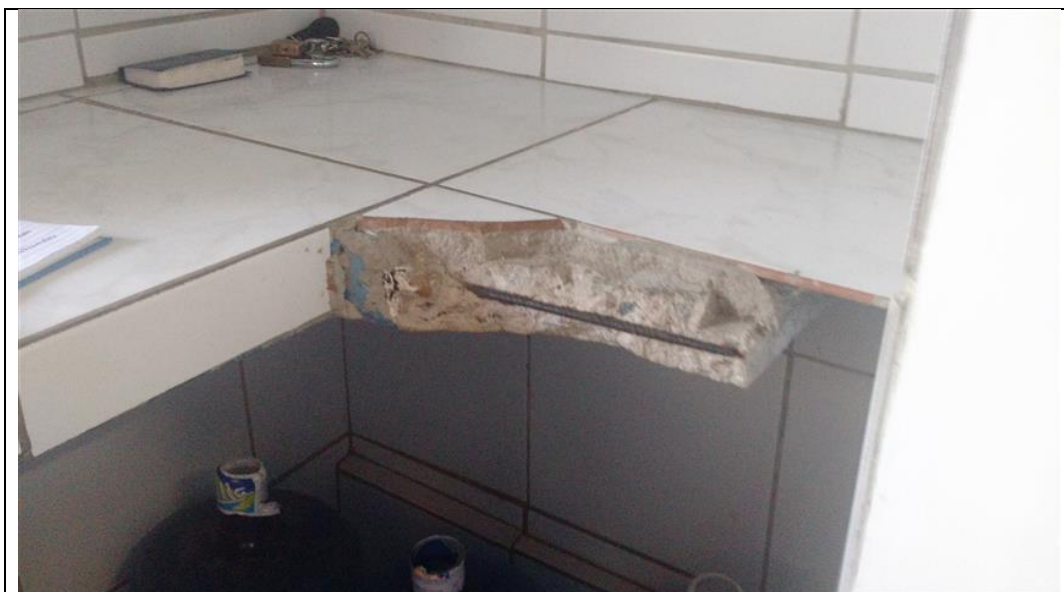
Foto - Balcão da cozinha com frestas nos azulejos, Ilha de Itamaracá (PE), 01 de julho de 2016
