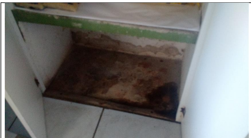
Foto - Infiltração no armário utilizado para armazenar os gêneros alimentícios, Ilha de Itamaracá (PE), 01 de julho de 2016
