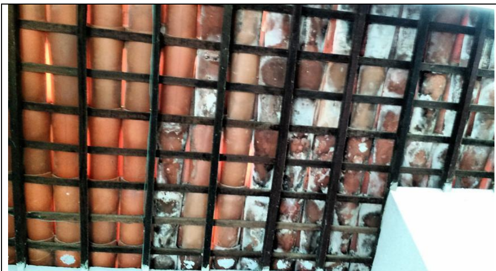
Foto - Teto com aberturas permitindo a entrada de insetos e outros contaminantes, Ilha de Itamaracá (PE), 30 de junho de 2016
