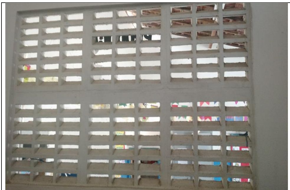
Foto - Janelas abertas sem telas milimétricas de proteção, Ilha de Itamaracá (PE), 01 de julho de 2016
