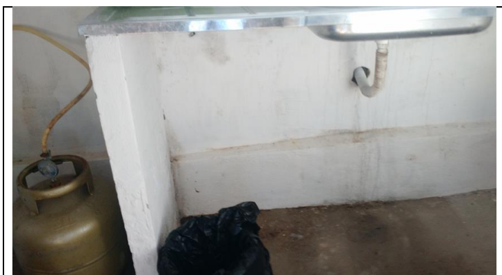
Foto - Lixo no interior da cozinha acondicionado em recipiente inapropriado e sem tampas de proteção, Ilha de Itamaracá (PE), 01 de julho de 2016
