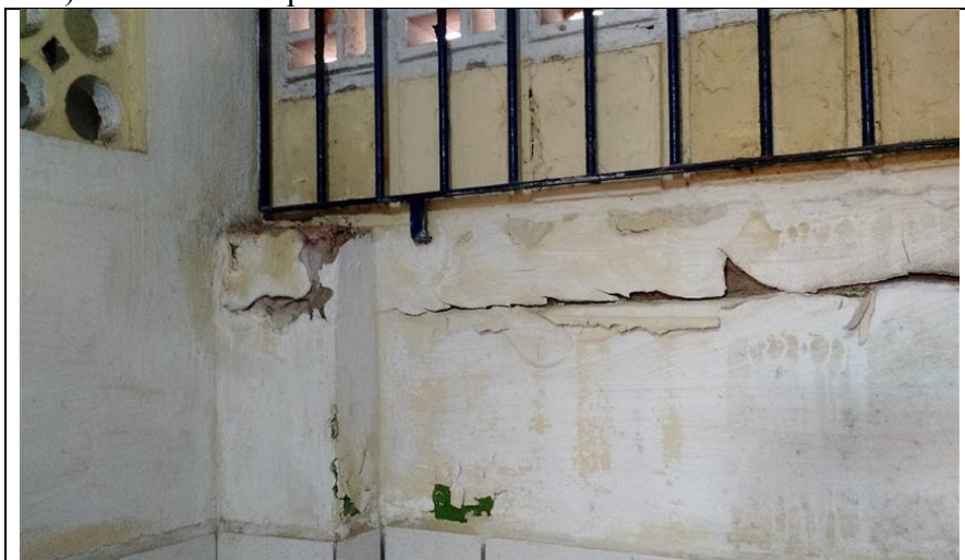
Foto - Infiltração na parede da cozinha, Ilha de Itamaracá (PE), 30 de junho de 2016
