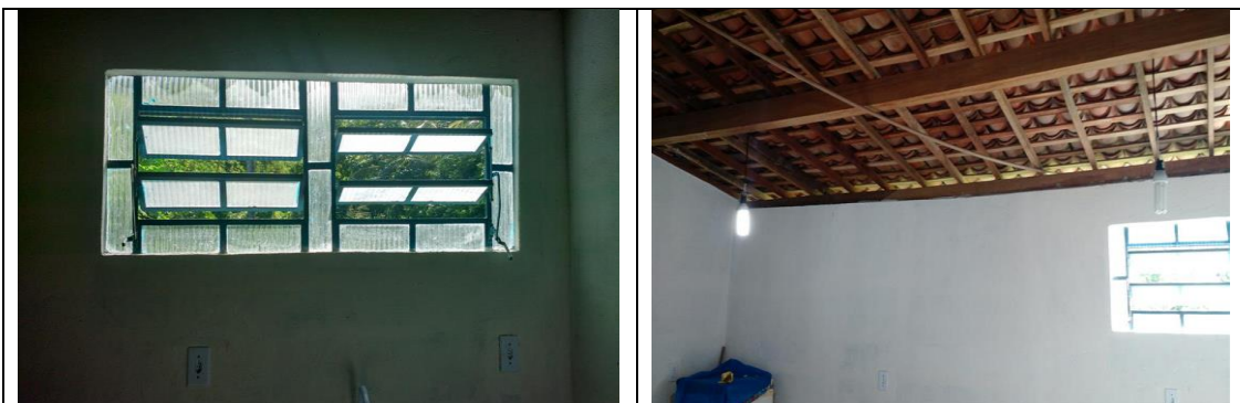
Foto -Janela sem tela de proteção milimétrica, , Ilha de Itamaracá (PE), 01 de julho de 2016
